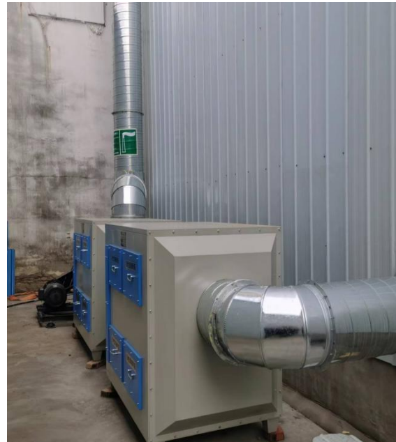
废气处理设施
