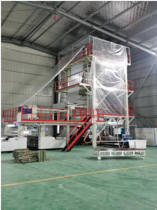
废气收集设施
